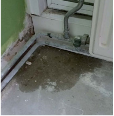
Bij hevige regen stroomt water in de woning via de poreuze kozijnen.
