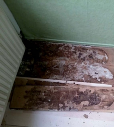
Schimmel op vloer (Gouvernestraat)
